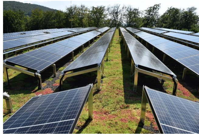
Gründach mit Photovoltaik © Optigrün International AG
