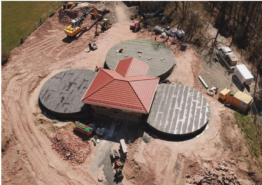
Sanierung und Erweiterung des Hochbehälters in Großenlüder – drei Kammern mit 1.400 m 3 Füllvermögen
