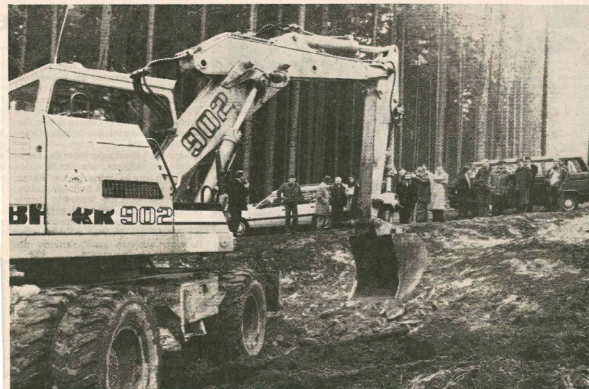
Der Bagger gräbt einfach und schnell die Flutmulden in den Waldboden. Für die Delegation des Regierungspräsidiums Darmstadt gab's gestern Anschauungsunterricht im Orber Stadtwald zwischen Wegscheide und Haselbachtal. Bild: Kaminsky
