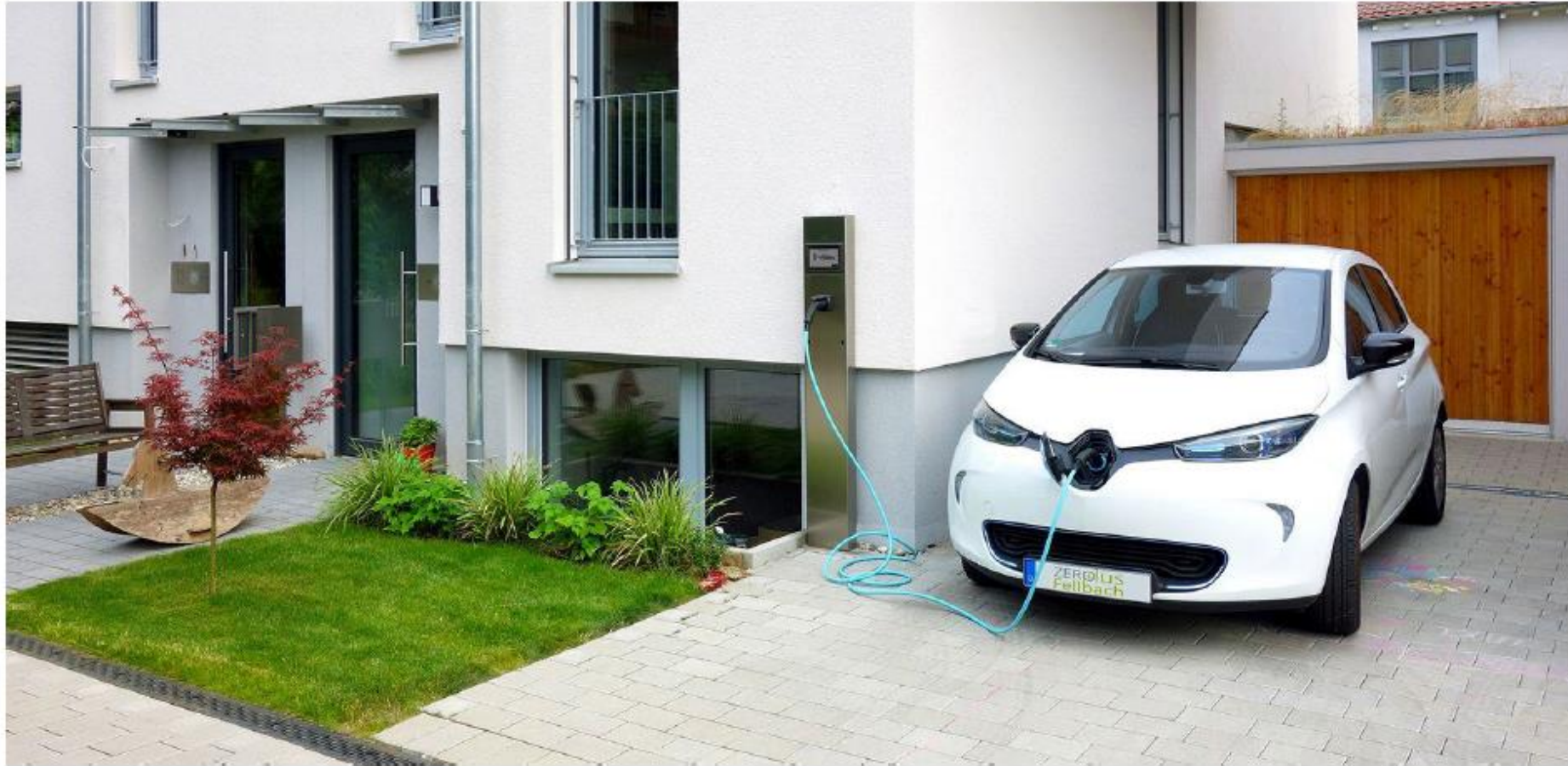
Foto: © Fraunhofer ISE
